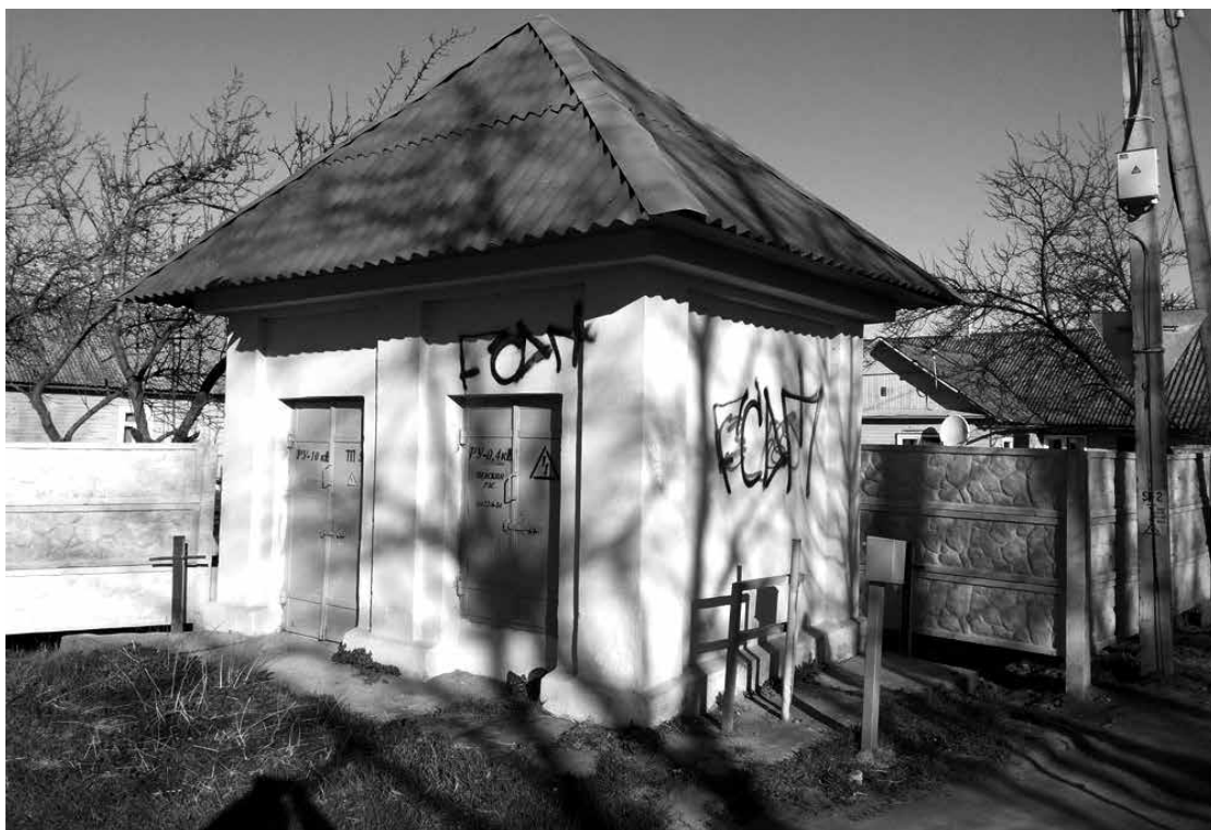
Адзіны захаваны да нашага часу трансфарматарны пункт фірмы «Ганц» па вуліцы Варшаўскай
