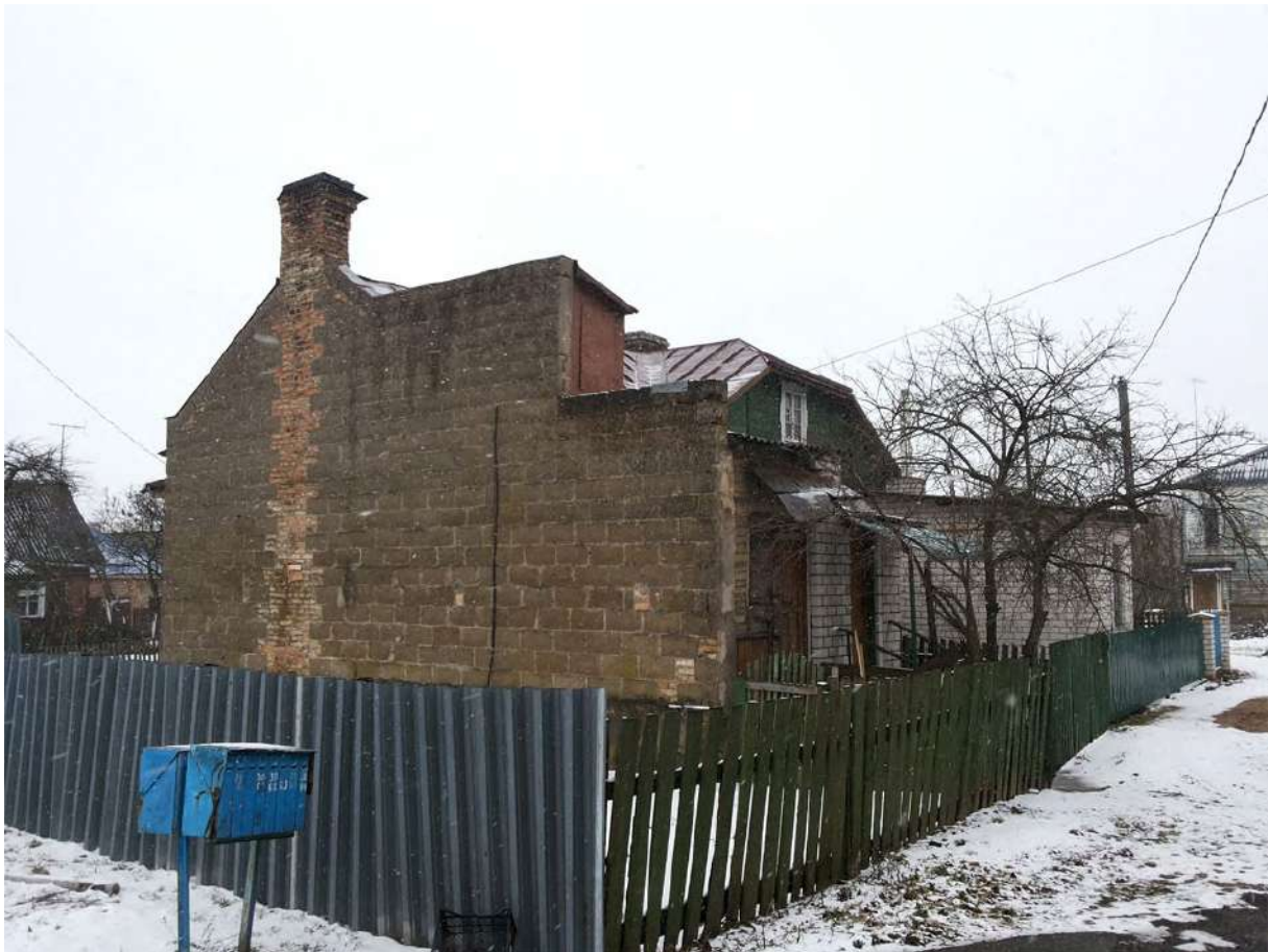
115. Dom z zaporą ogniową, ul. Sowiecka 30b.
